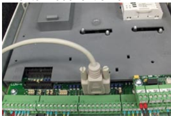
Den Antrieb (X34) mit dem PC über einen COM Port verbinden
